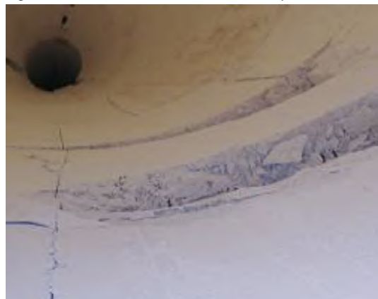
Figura 2: Concreto refratário com dano explosivo
