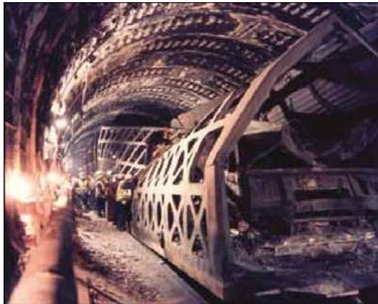
Figura 1: Danos ao túnel da Mancha
