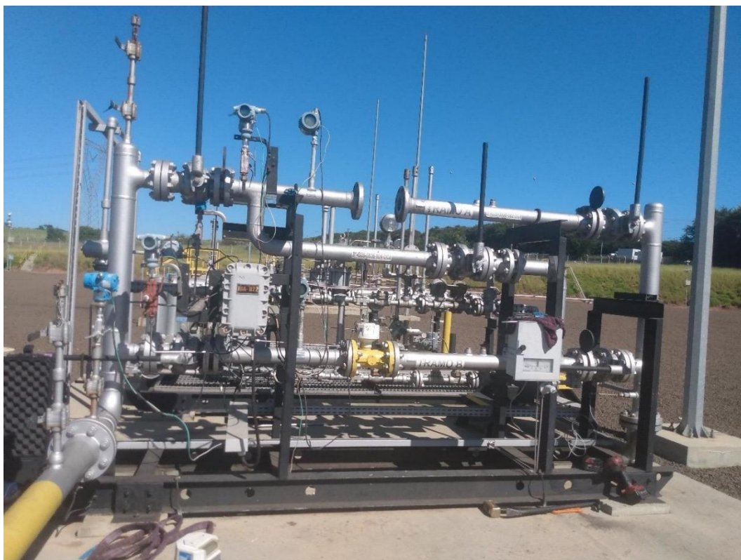
Figura 13 - Sistema de medição de transferência de custódia de uma refinaria
