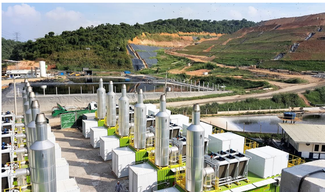
Figura 8 - Usina termoelétrica de Nova Iguaçu movida a biogás Fonte: Canaonline, 2019
