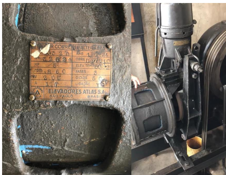
Figura 23: Regulador de velocidade encontrado em visita técnica (Fonte Autores)
