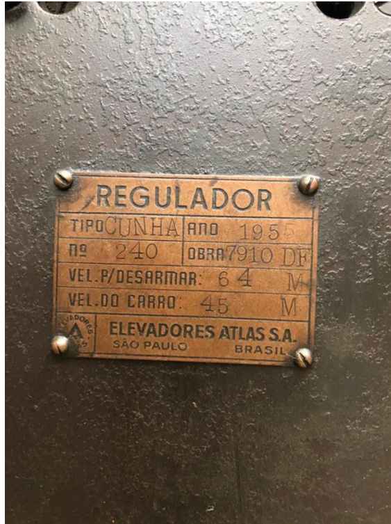
Figura 27: Regulador de velocidade encontrado em visita técnica (Fonte Autores)
